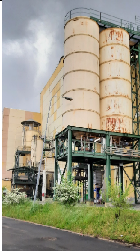
In primo piano i due silos di stoccaggio polveri, in secondo piano zona stoccaggio scorie e ceneri pesanti, sullo sfondo silos ceneri
